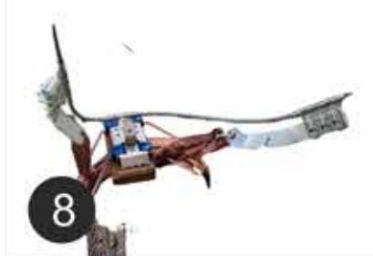
8 Vérification de la corrosion sur tous les éléments IMN&CLiC-iT LDV installés (ancrages, bras, anti-retours, etc...)
