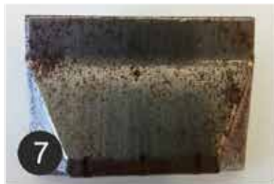
7 Vérification de la corrosion sur les composants du DCM
